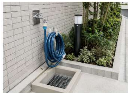
洗浄設備・排水設備の例
