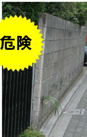
傾いている塀
