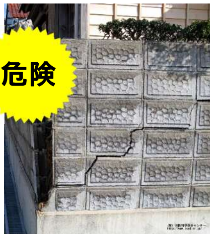
劣化損傷の著しい塀
