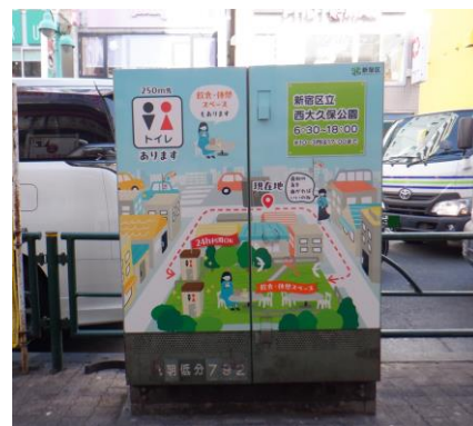
配電地上機器ラッピングによる周知
