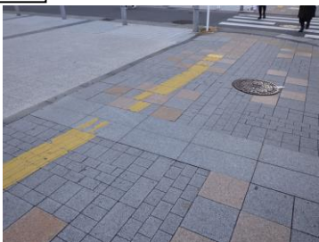
視覚障害者誘導用ブロック 劣化箇所
