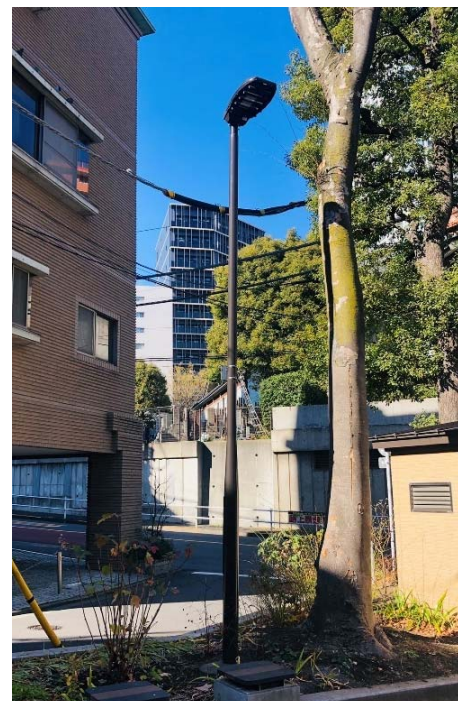
停電時に利用可能なバッテリー内蔵型の照明灯
