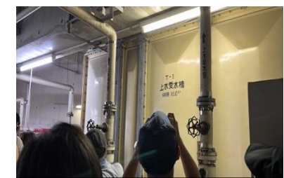
受水槽見学 避難者飲料水確保用の受水槽を見学
