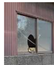
窓が割れた 管理不全空家
