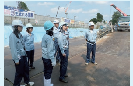
現場の設備を点検するダイバーシティパトロール
