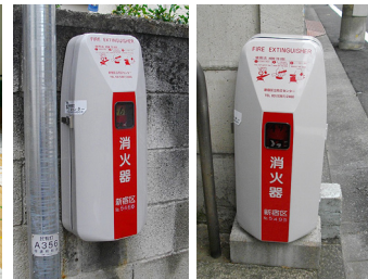
消火器の設置例
