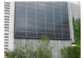
▲創エネを行う太陽光発電パネル
