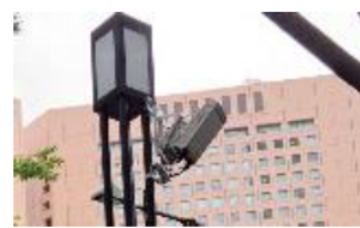
4 通信事業者の5Gアンテナを設置
