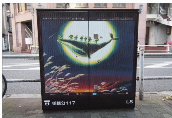
「四季の道」 （区役所通りトランスボックス）
