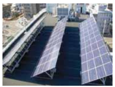
太陽光パネル(徳島第一号合同庁舎)
