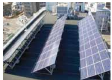
太陽光パネル(徳島第一号合同庁舎)
