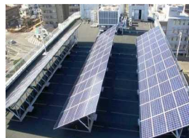
太陽光パネル(徳島第一号合同庁舎) 出典：インフラ空間を活用した 太陽光発電の推進 国土交通省 ( https://www.mlit.go.jp/common/001030577.pdf )
