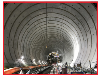
環状七号線地下広域調整池の整備
