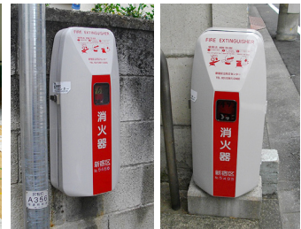
消火器の設置例
