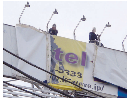
屋外広告物の安全対策
