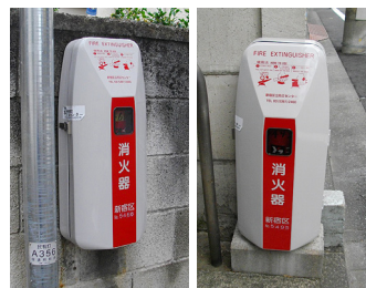
消火器の設置例
