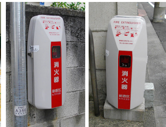
消火器の設置例
