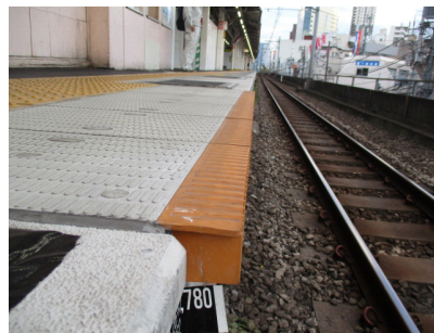
◎くし状ゴムの設置により車両との隙間を解消している
