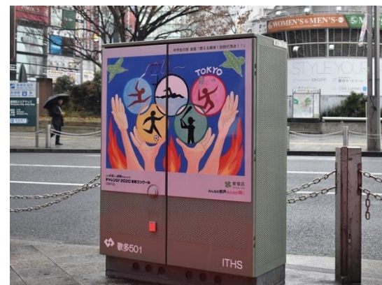
配電地上機器の装飾
