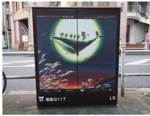
「四季の道」(区役所通りトランスボックス)
