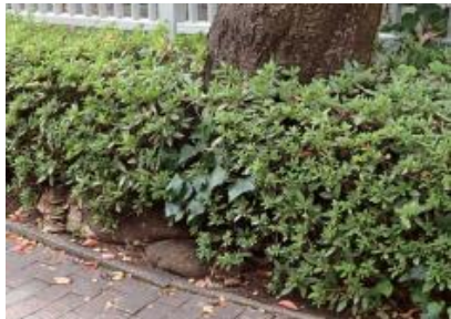
根上がりによる舗装の劣化、大径木化
