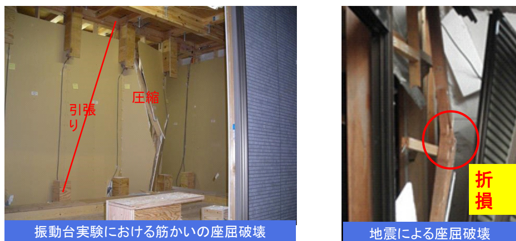
図1-22 筋かいの座屈破壊
