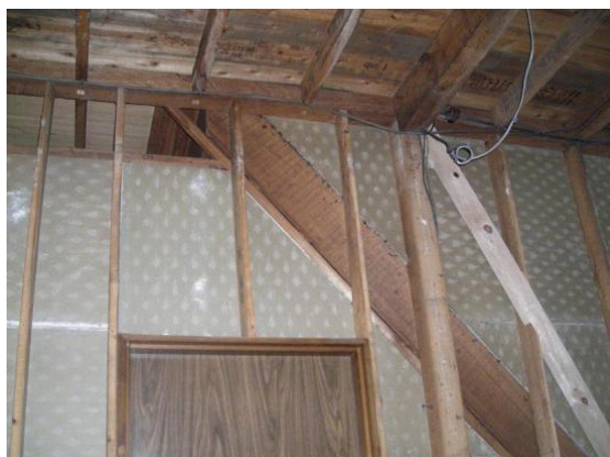
図1-10 ラスボードと階段ササラの干渉
