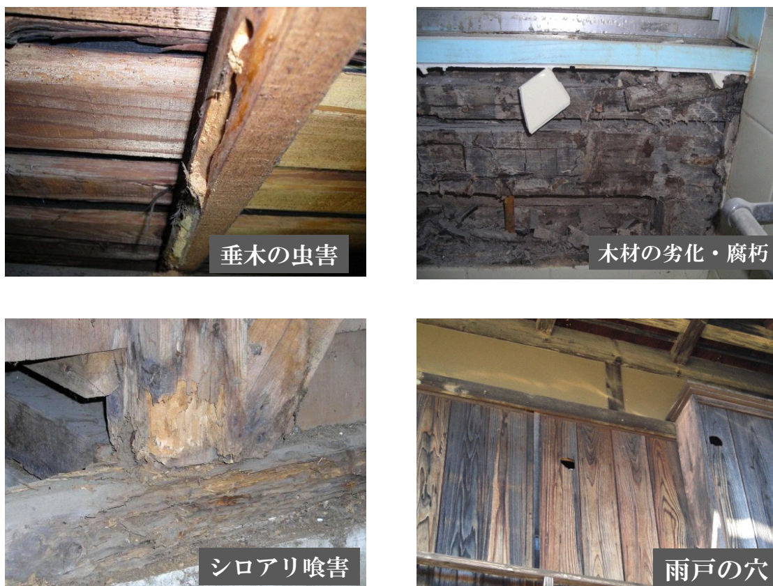
図1-20 劣化部の写真
