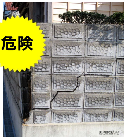
劣化損傷の著しい塀 出典 一般財団法人 消防防災科学センター
