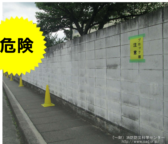
道路沿いの高さが高い塀 出典 一般財団法人 消防防災科学センター http://www.isad.or.jp/
