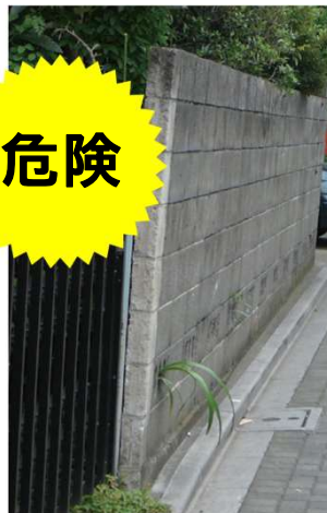
傾いている危ない塀 出典 一般財団法人 日本建築防災協会
