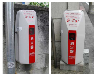
消火器の設置例
