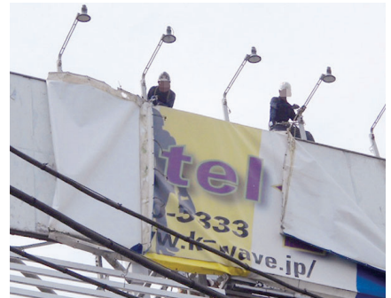
屋外広告物の安全対策
