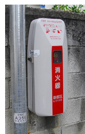
消火器の設置例
