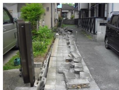
熊本地震の被害状況
