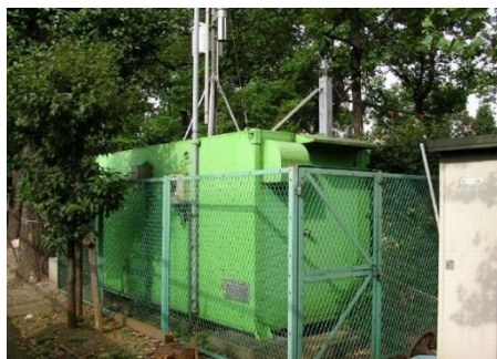
四谷自動車排出ガス測定局
