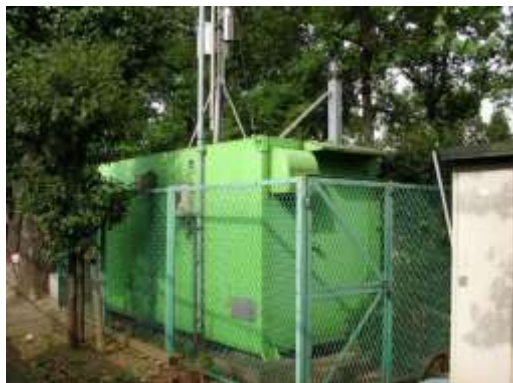
四谷自動車排出ガス測定局
