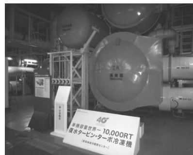
西新宿の地域冷暖房設備
