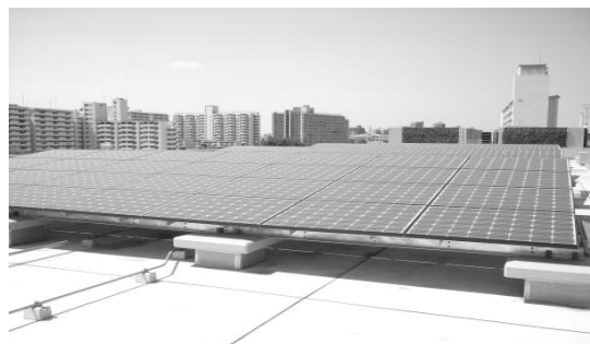
子ども総合センターの太陽光発電施設(20kW)
