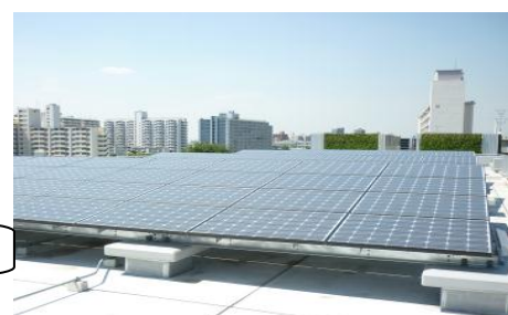
子ども総合センターの太陽光発電施設 (20KW)
