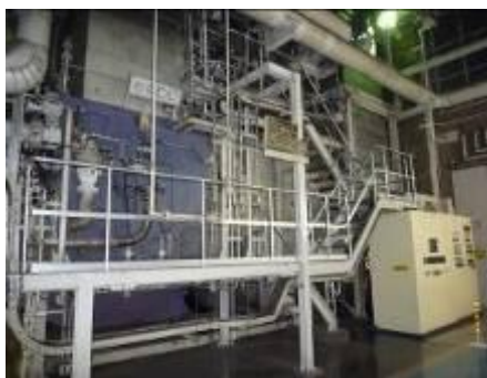
新宿副都心の地域冷暖房設備
