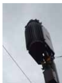
柱上トランス
