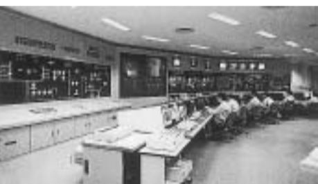
工場の施設を運転・監視します。
